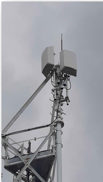
Antennes TNT du site TDF de Tiari Province Nord
